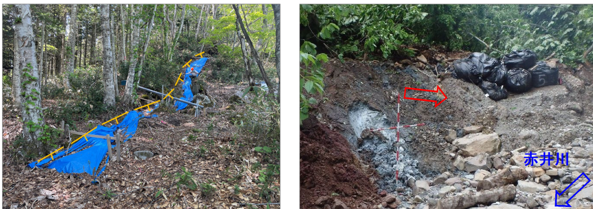
写真-2 斜面頭部の拡大亀裂（応急対策としてブルーシートで養生）（上）
