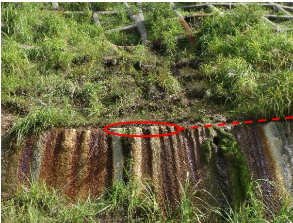
正面から見た侵食状況
