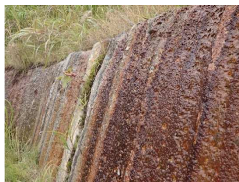
コンクリートの侵食 2022.10.06
